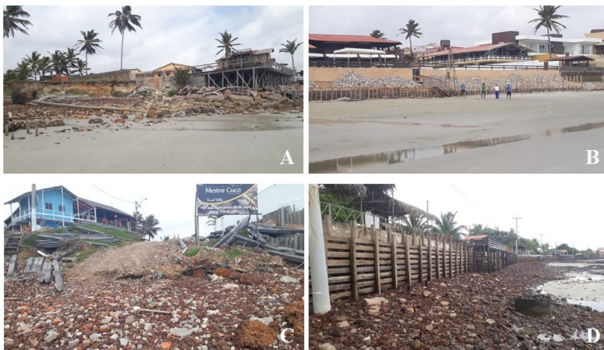
Figura 5 – Processos erosivos nas praias do Atalaia (A, B) e Farol Velho (C, D)
