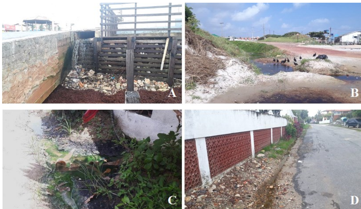
Figura 6 – Lançamento irregular de esgoto nas praias do Atalaia (A, B) e Farol Velho (C, D)
